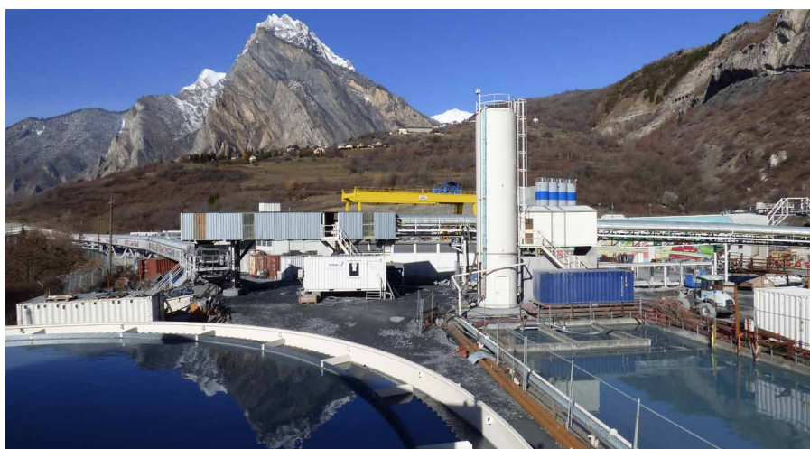
Le nouveau décanteur de 18 m de diamètre
